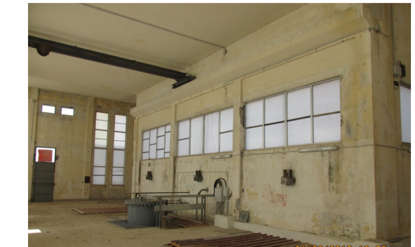
foto 8 immagine interna dell'impianto idrovoro Gelsari
