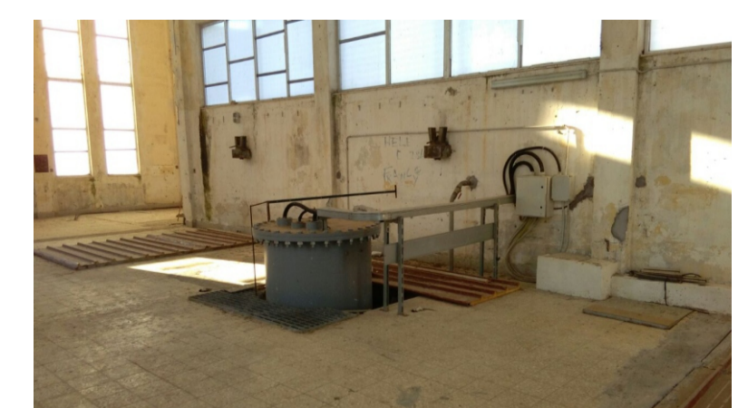
foto 6 immagine interna dell'impianto idrovoro Gelsari
