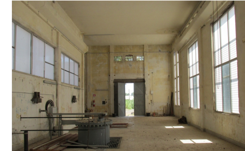
foto 7 immagine interna dell'impianto idrovoro Gelsari
