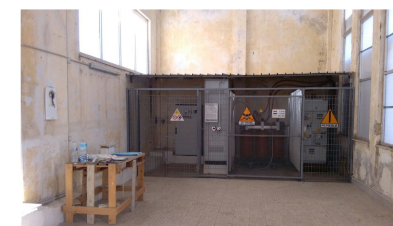
foto 5 immagine interna dell'impianto idrovoro Gelsari
