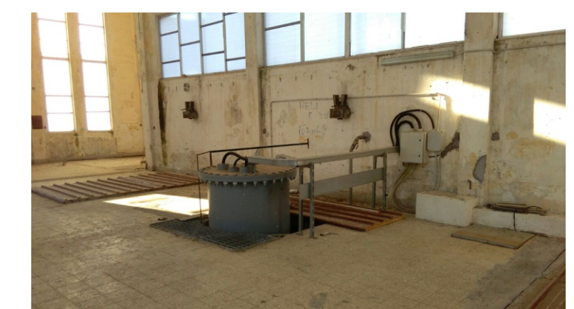
foto 6 immagine interna dell'impianto idrovoro Gelsari
