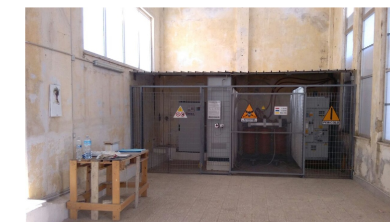
foto 5 immagine interna dell'impianto idrovoro Gelsari
