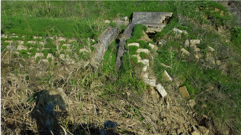
Figure 6 : foto dell'argine di un canale principale scalzato dalla furia della piena
