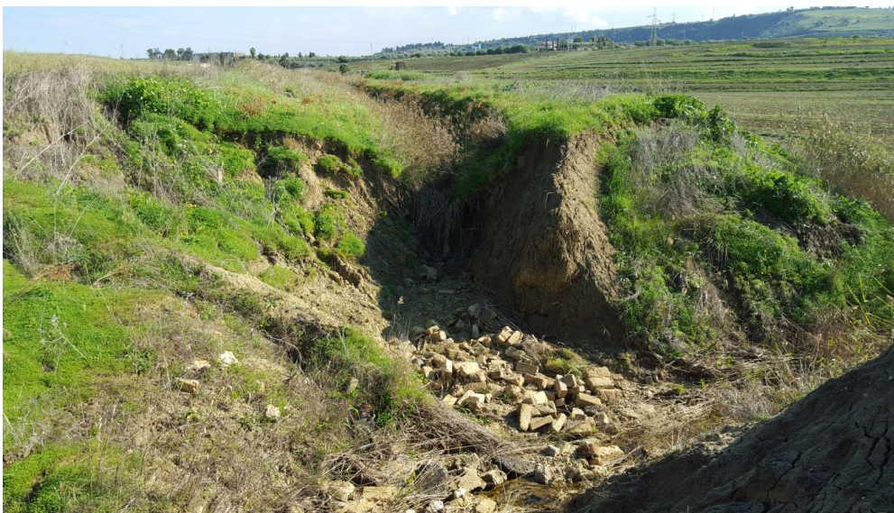
Figure 5: foto dell'argine di un canale principale scalzato dalla furia della piena
