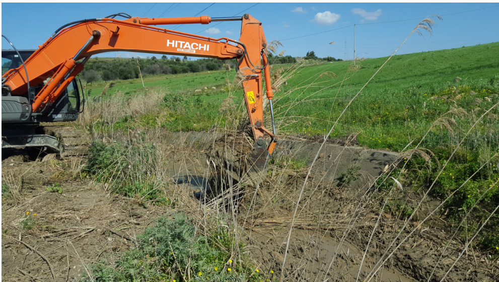
Figure 7 : fotodella rimozione dell'intasamento localizzato di un canale a seguito dalla furia della piena
